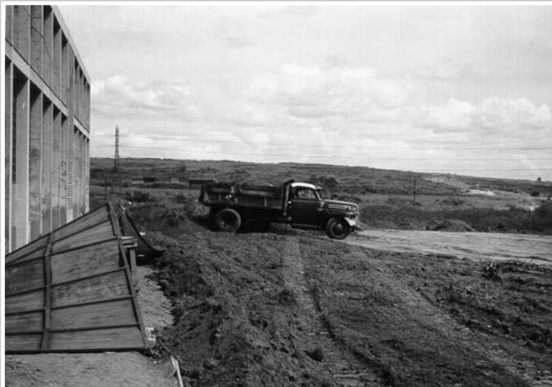
Década de 50 –Foto da terraplenagem para a construção da fábrica da ZF. Ao fundo, a Avenida Delamare em direção ao bairro do Ipiranga
