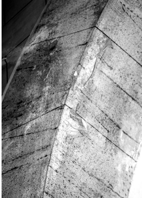
Pintura descascada nas colunas da matriz
