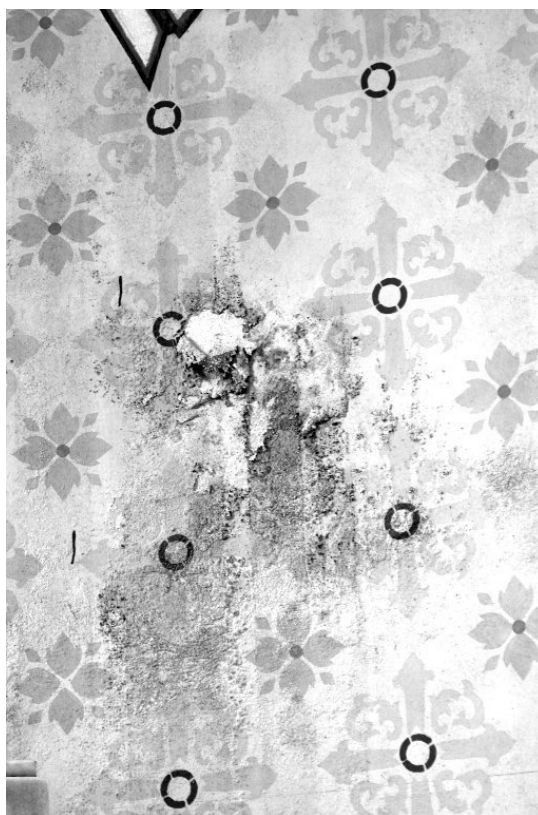
Mais sinais de infiltração de água. No detalhe, a capela da Sagrada Família sem a estátua
