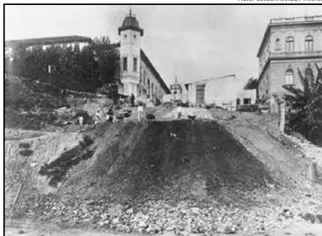
Obras de implantação do Viaduto Santa Efigênia, saindo do Largo de São Bento, em 1909, no local em que existiu a enfermaria dos escravos do Mosteiro de São Bento e das fazendas beneditinas
